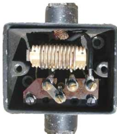
Abb. 11: Antennenzuleitung i; Kasten Pz. Nr. 9a geöffnet
