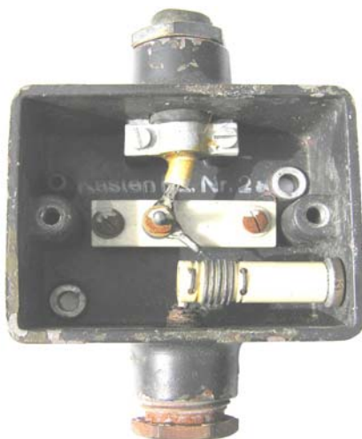
Abb. 18: Antennenzuleitung n; Kasten R geöffnet
